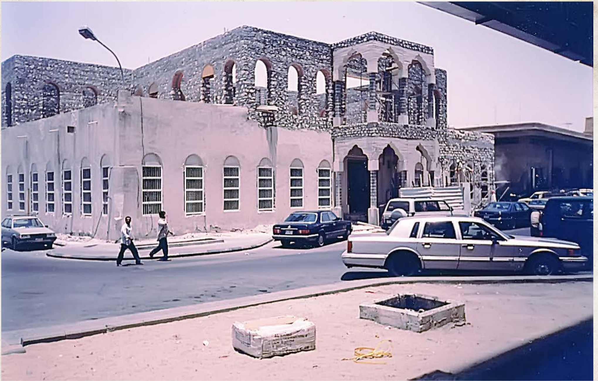
مدرسة الهفوف الأولى أثناء الترميم
